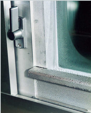
結露状況写真
